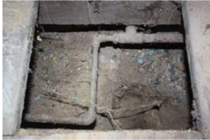
Plate 14: Internal Test Pit F1
